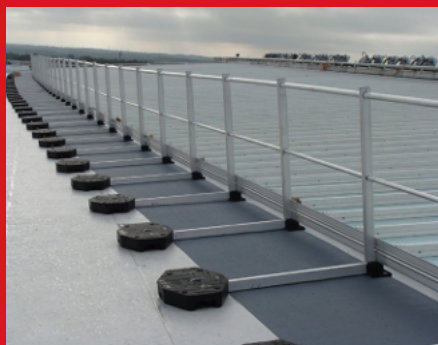
Dachabsperrungen zum kollektiven Schutz
