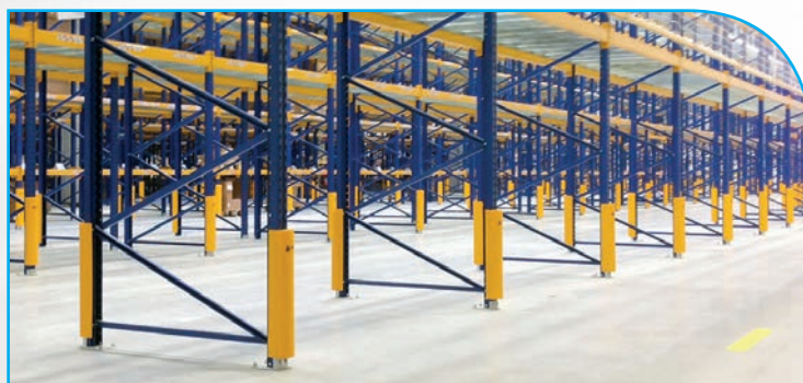
Komplette Installation im Lager der Firma Schneider Electronics – Frankreich
