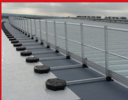
Dachabsperrungen zum kollektiven Schutz
